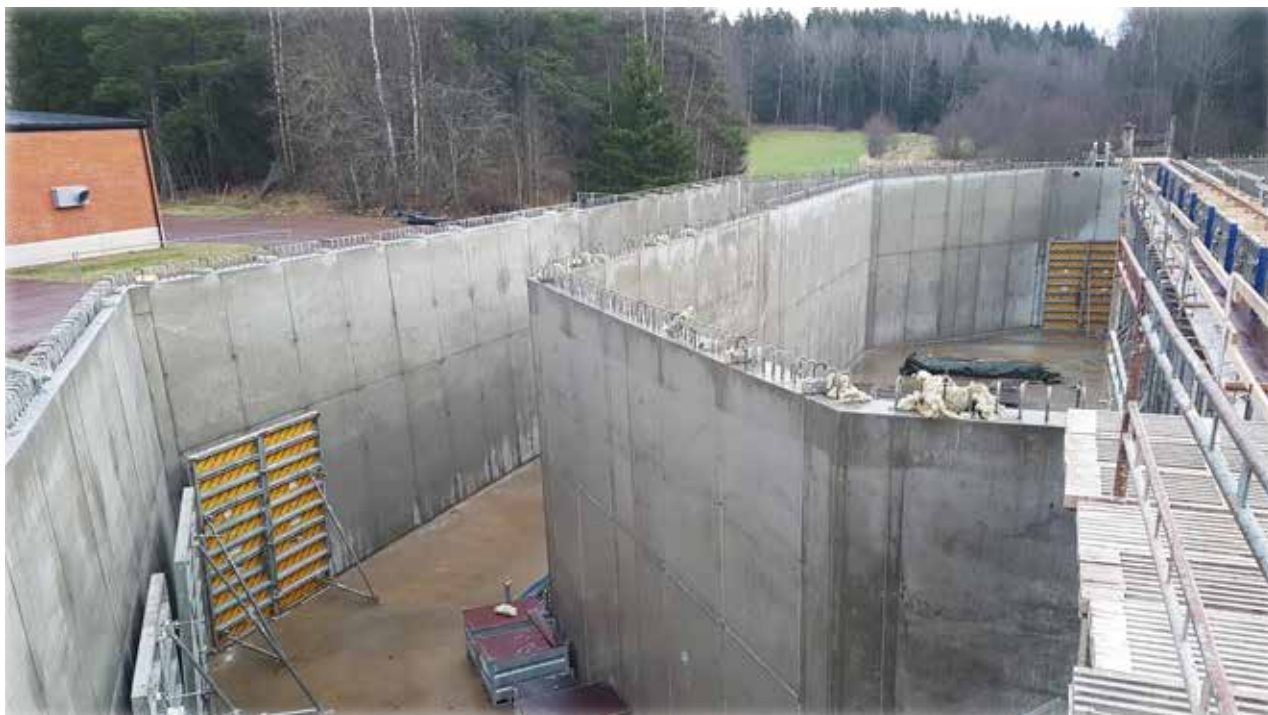
Ny lågreservoar vid vattenverket.
