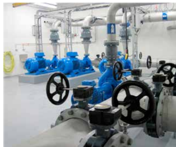
Interiör från nya lågreservoaren.
