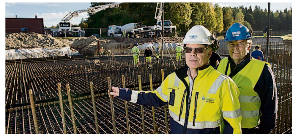
Vattenförsörjningen blir säkrare när bufferten ökar med 6.000 kubikmeter dricksvatten. Det är en förebyggande åtgärd, enligt Ålands vattens planeringsingenjör Gottfrid Öhberg och vd Christian Nordas.
